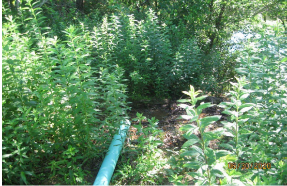
Luzerne Mine Discharge Pipe
