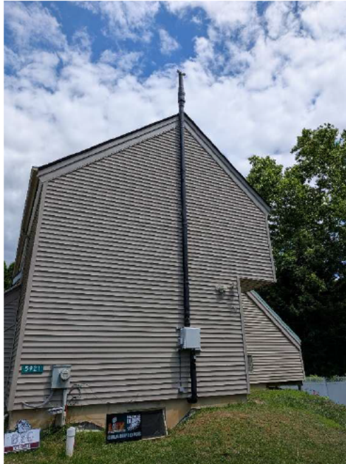
Effluent discharge and fan
