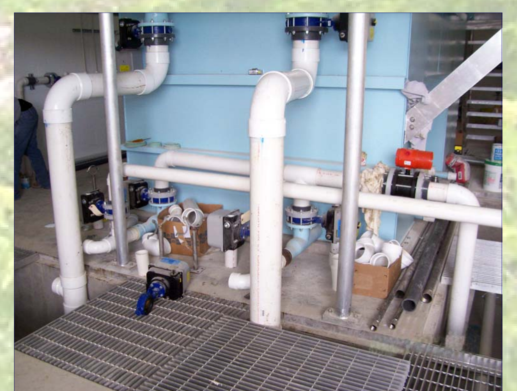
Effluent & Backwash Piping
